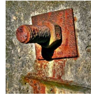
Verrostetes (korrodiertes) Bauteil aus Eisen
